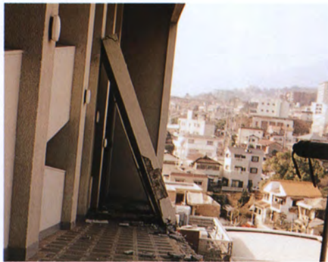
壁が落下した北側スロープ①
