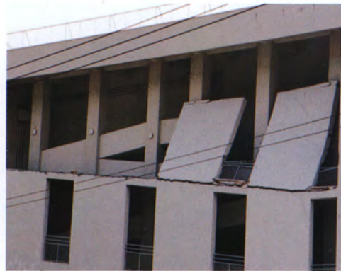
壁が落下した北側スロープ②
