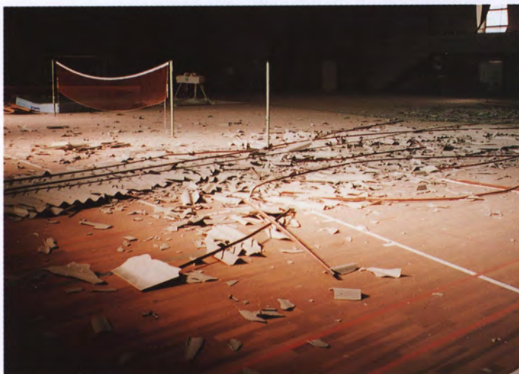
天井の照明器具が落下した講堂兼体育館のフロア
