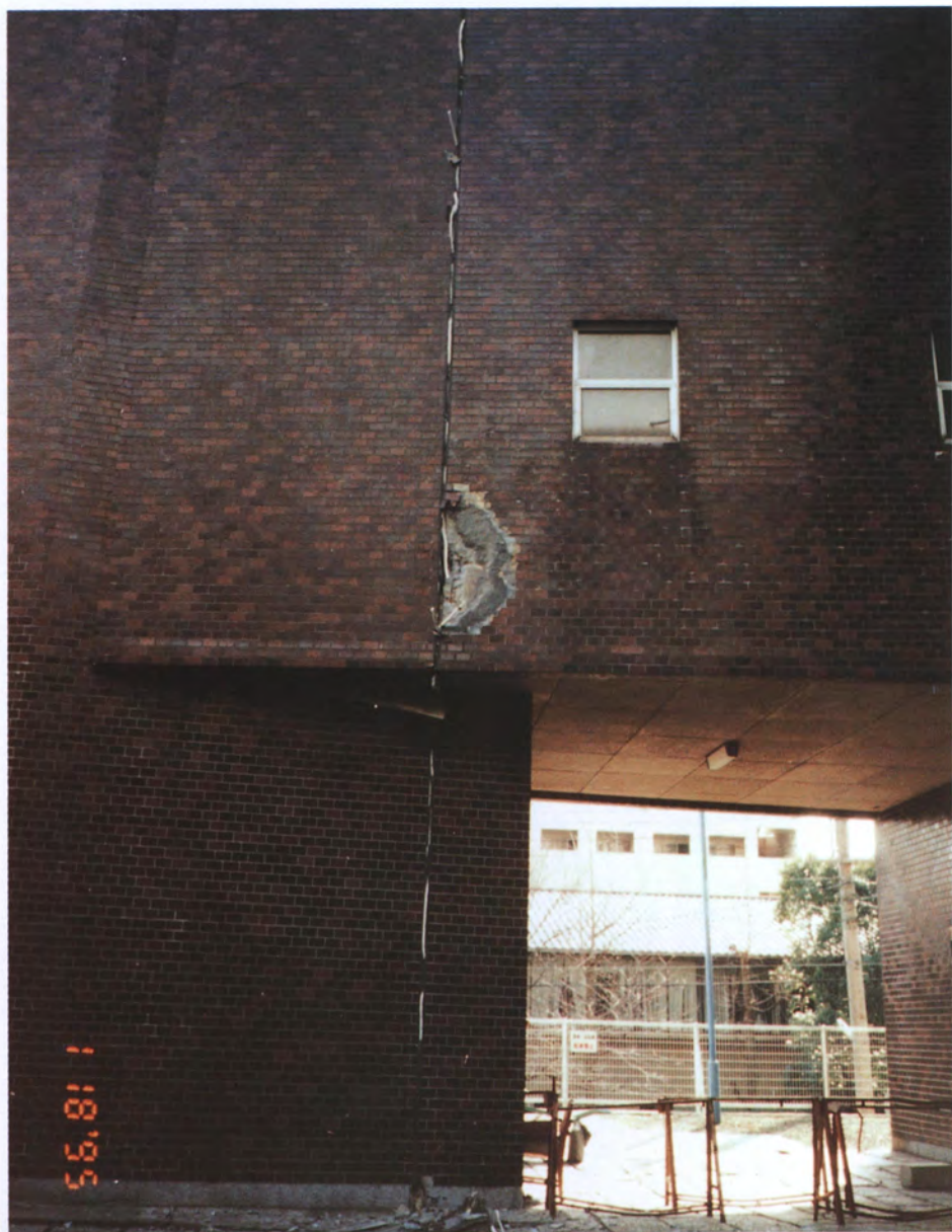
大きく亀裂が入った講堂兼体育館時計台北側
