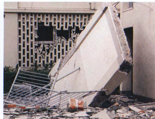
壁が落下した北側スロープ③
