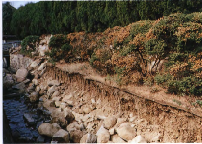
南側の崩れた石垣
