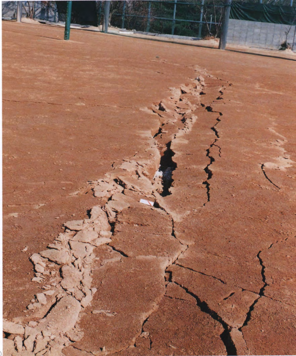
大グラウンドの地割れ部分①
