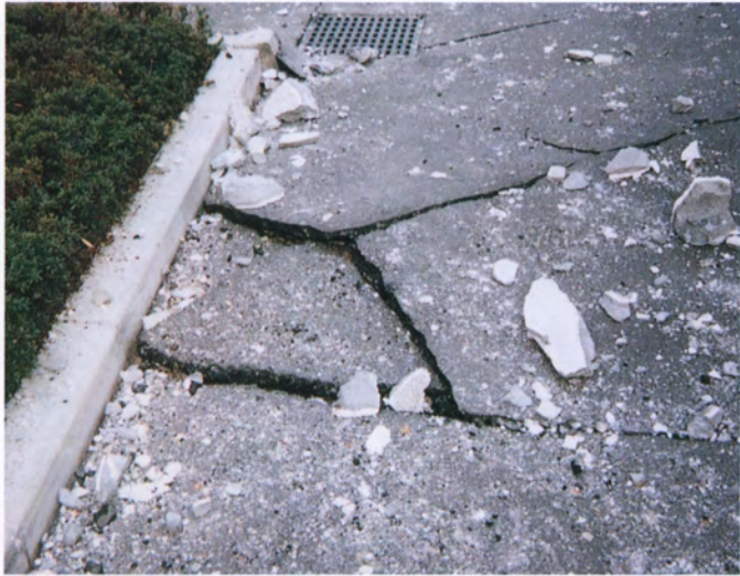
2号館北側の地割れ
